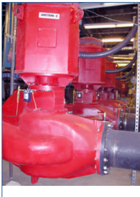
Enwave 区制冷设施， 加拿大多伦多。
