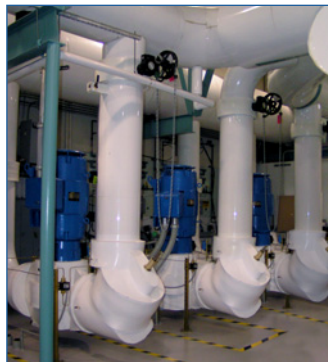
Projet de refroidissement de district, à Phoenix, aux États-Unis.
